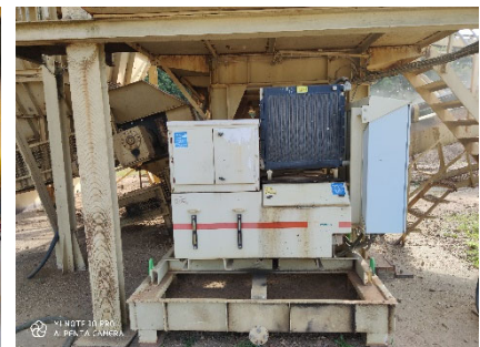
Groupe hydraulique de l'installation avec rétention
